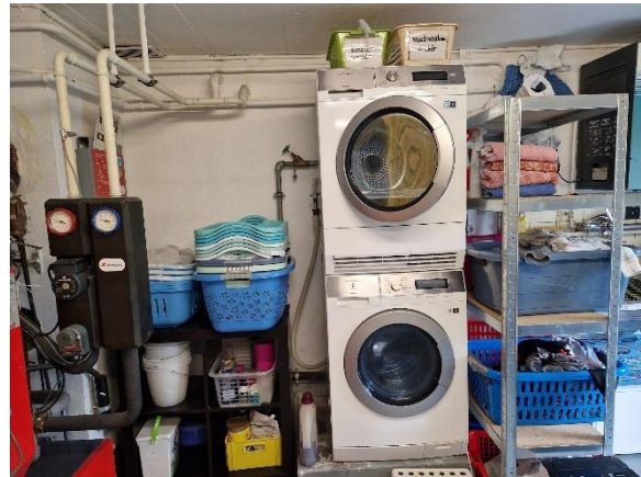
Hauswirtschaft und Heizung Untergeschoss
